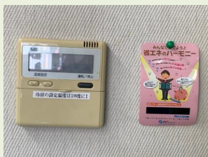
事務所室温の管理
