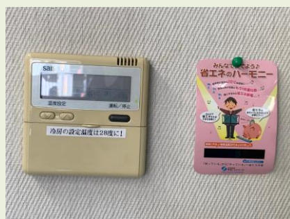
事務所室温の管理
